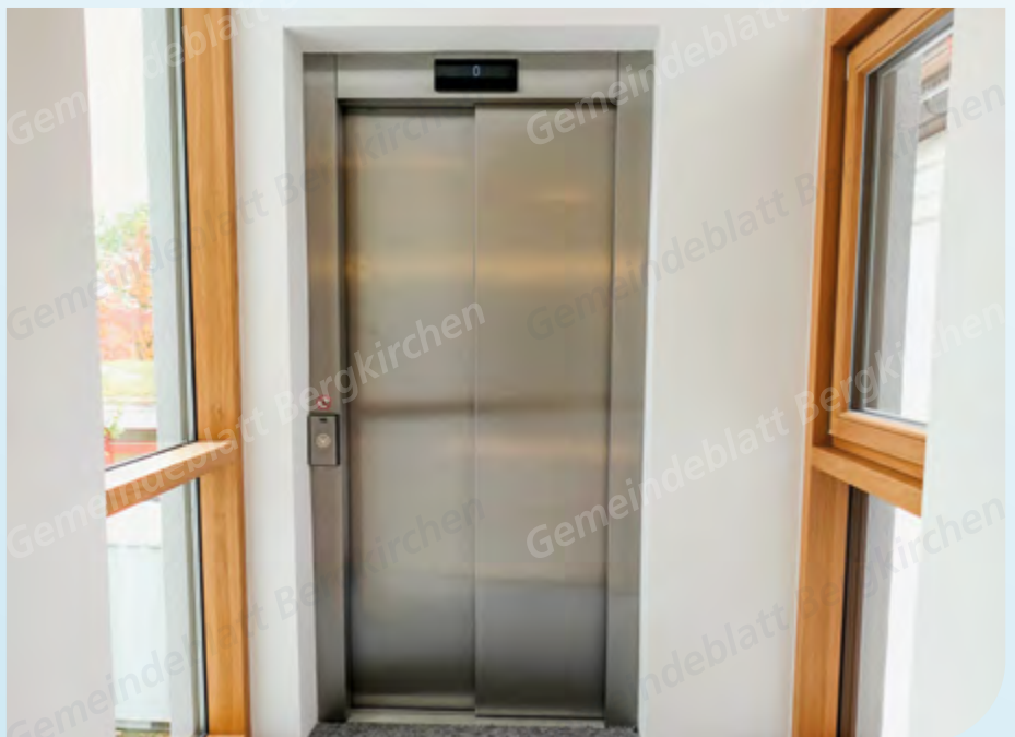
Der neue Aufzug im Rathaus.
